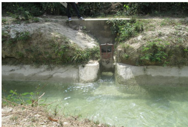
Figure 7 : Porte d'un canal secondaire dysfonctionnel sans cadenas ni appareil contrôlant le débit
