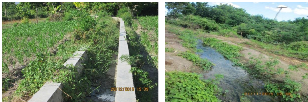
Figure 9 : Vue de deux portions de canal mal entretenu dans la zone de travail
