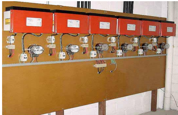
Figura 10- Instalación del centro CEPEL ELETROBRAS, en Río de Janeiro, Brasil.
